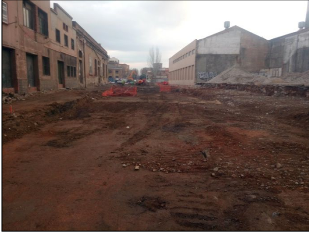
F1.- Vista general del carrer del Marroc, amb els rebaixos inicials realitzats.
