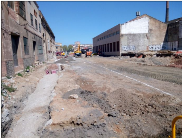
F23.- Vista general del tram d'obra amb el traçat de clavegueram ja col·locat.
