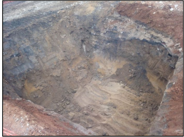
F10.- Vista general d'una de les fosses destinades a les arquetes corresponents al traçat de la RSU.
